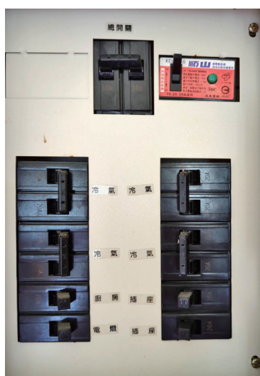
★ 圖 (1) 配電盤外觀圖
